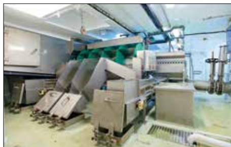
Ook buiten de grenzen zet VCU-TCD steeds meer voet aan de grond. De foto is de vangstverwerkingsinstallatie op een Noor.
